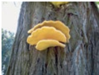
LES CHAMPIGNONS PROVOQUENT UNE POURRITURE DU BOIS, ENTRAÎNANT UNE BAISSÉ DE SA RÉSISTANCE MÉCANIQUE POUVANT CONDUIRE AU BASCULEMENT OU À LA RUPTURE DU TRONC
