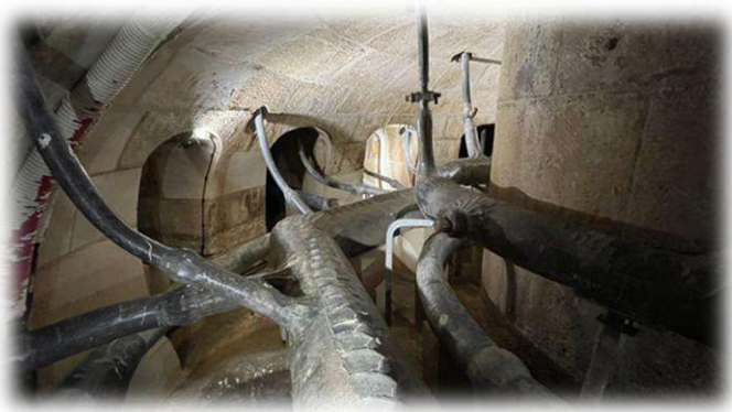
L' « araignée » d'alimentation du bassin de Latone
